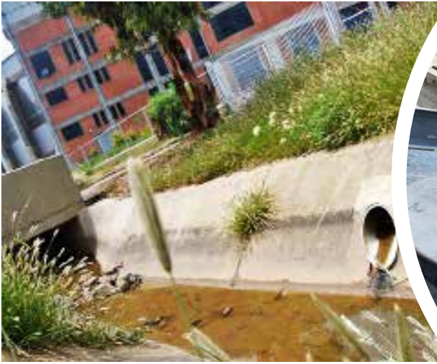
Conexiones clandestinas de aguas servidas.
